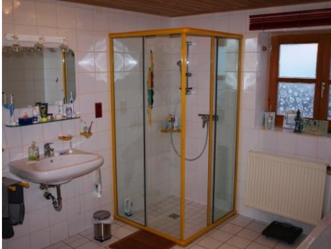
Dusche im Badezimmer
